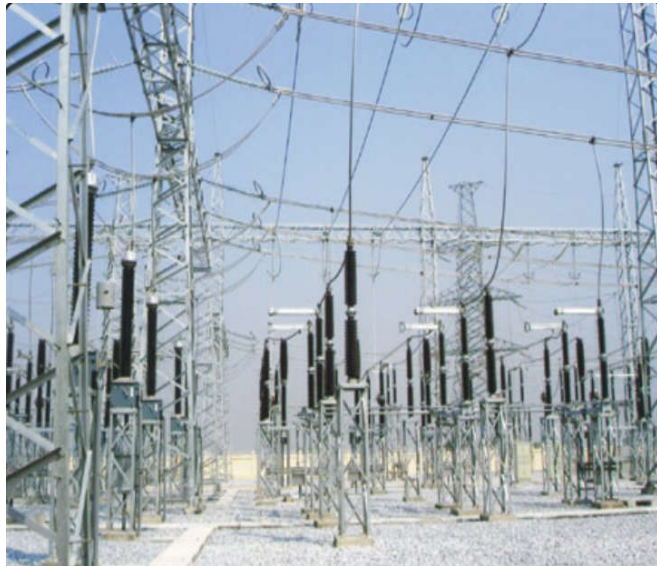
Hình 13. Trạm biến áp 500kV
