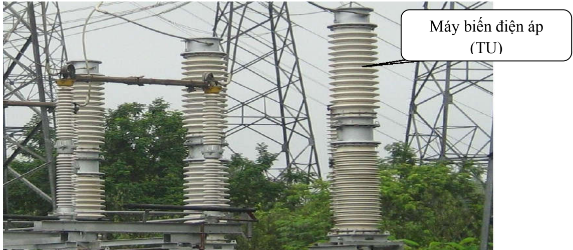
Hình 18. Máy biến điện áp (TU)
