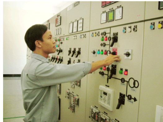
Hình 14. Vận hành 1 tổ máy
